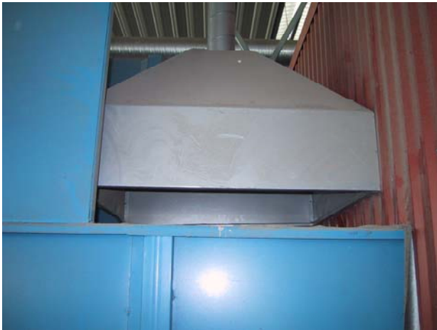
Figur 5. Avtrekk over sorteringsbånd rett før inngang til sorteringshus
