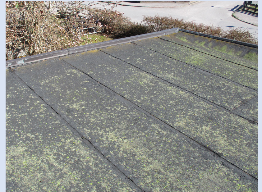
Äldre papptak som behöver bytas ut.
