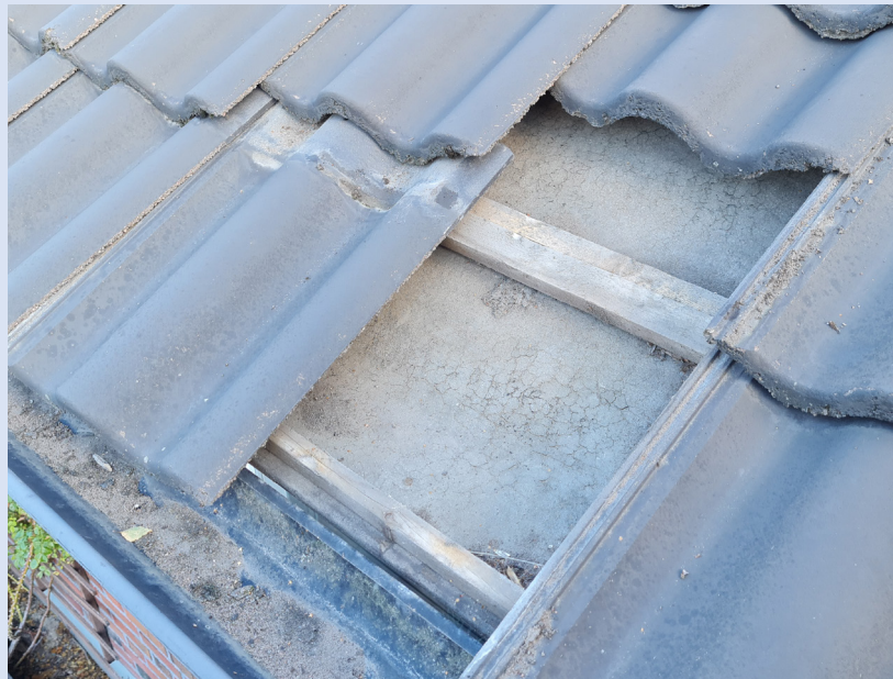
På bilden syns ett underlagstak av träfiber utan underlagspapp, vilket ger ett bristande fuktskydd. Om vatten läcker in kan träfiberskivan ändra form och inte leda bort fukten.
