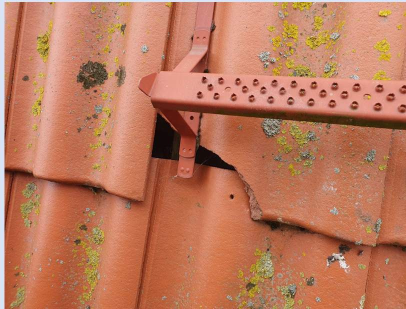
Trasig takpanna intill takstegen, vilket innebär en ökad risk för fuktskador.
