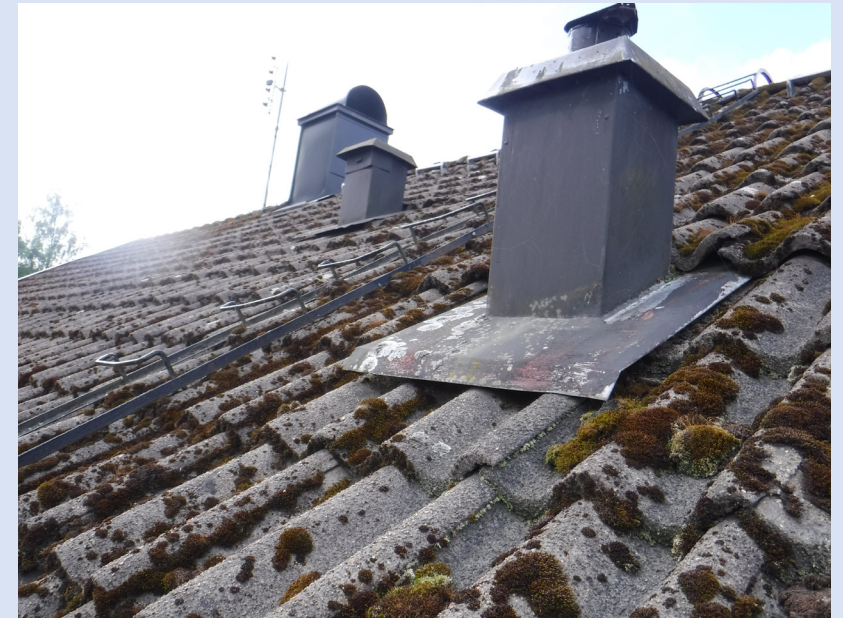
Tak med takpannor som är mosstäckt. Mossan ansamlar vatten, som kan orsaka frostsprängning och skada takpannorna.
