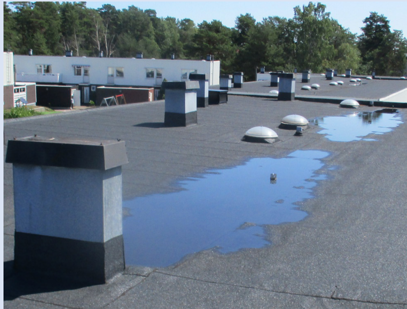
Ett platt papptak med vattenansamling som på sikt kan leda till att fukt tränger in i byggnaden och skada uppstår.
