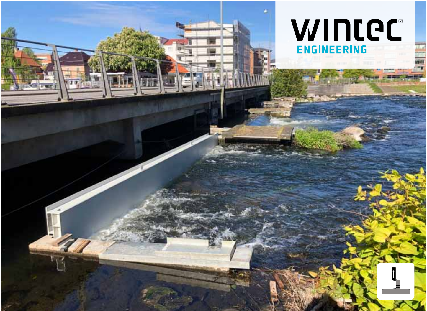
Faunapassagen, Silkeborg Papirfabrik, 3 vertikalsluser med overfald á 10m bredde samt frislusen – her afblændet pga tørke og et vandflow, der ligger under median minimums vandføring.
