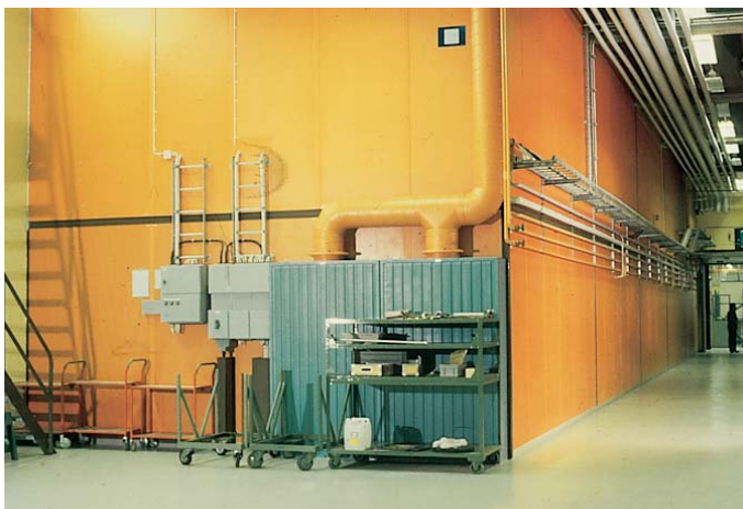
Schallschutzkapselung einer Großproduktionsanlage mit Deckenanschluss.
