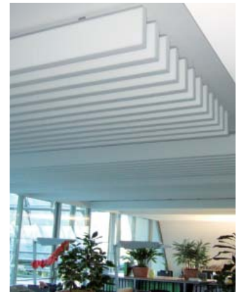
Büro mit Linearabsorbern zur Verbesserung der Sprachverständlichkeit (auch bei betonkernaktiven Decken).
