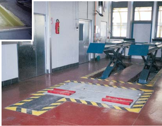
Das gesamte Fundament für eine Hebebühne wurde mit Sylomer® Typ M ausgekleidet.
