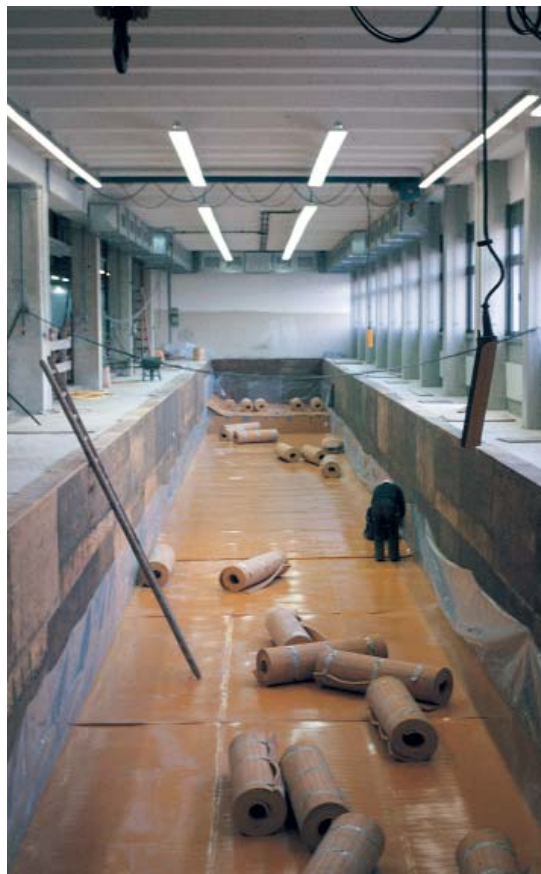
Durch die vollflächige Lagerung des Fundaments einer Crash-Test-Anlage auf Sylomer® kann das schwingfähige System auf unter 5 Hz abgestimmt werden.
