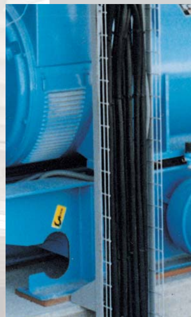
Vibrationsdæmpning af maskine ved hjælp af sylomer under maskinen
