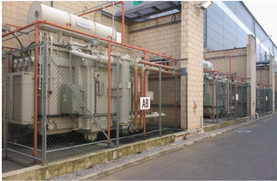
Figuur 3.4 — De transformatorruimten
