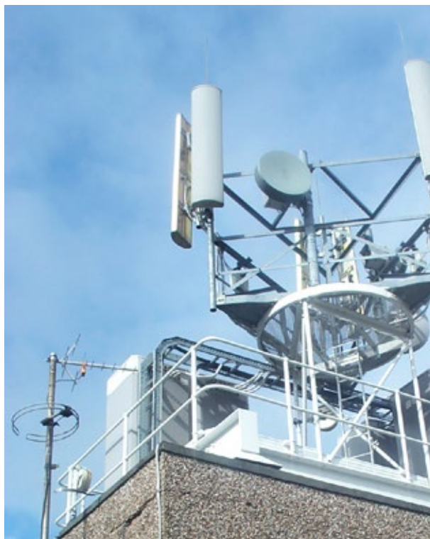
Figuur 10.1 — Sectorantennes voor mobiele telefoons en een schotelantenne op het dak van het liftgebouw
