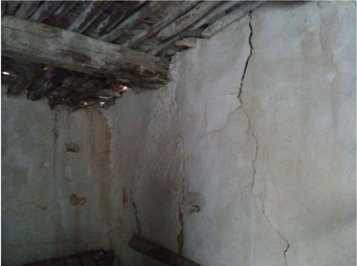
Vista de la patología estructural que presenta el muro de carga que separa la cuadra 1 de los bebederos.
