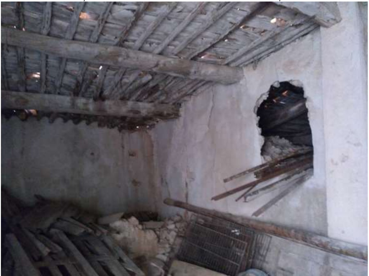
Vista del interior de la cuadra 1. A la derecha se aprecia el deterioro que presenta la estructura de cubierta y los muros del volumen que configura los bebederos y el aljibe.
