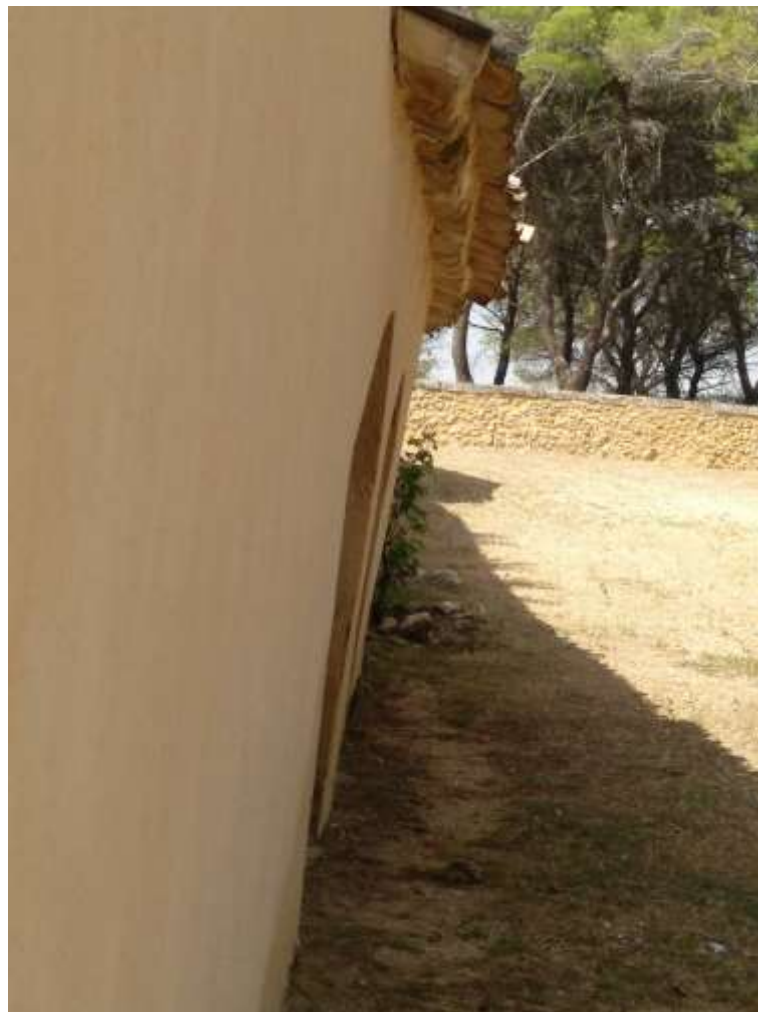
Vista del desplome del muro que configura los bebederos.
