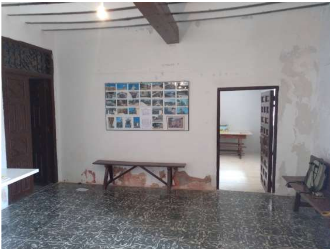
Vista del zaguan de la casa del santero. Se aprecian las humedades en las zonas bajas de los muros.
