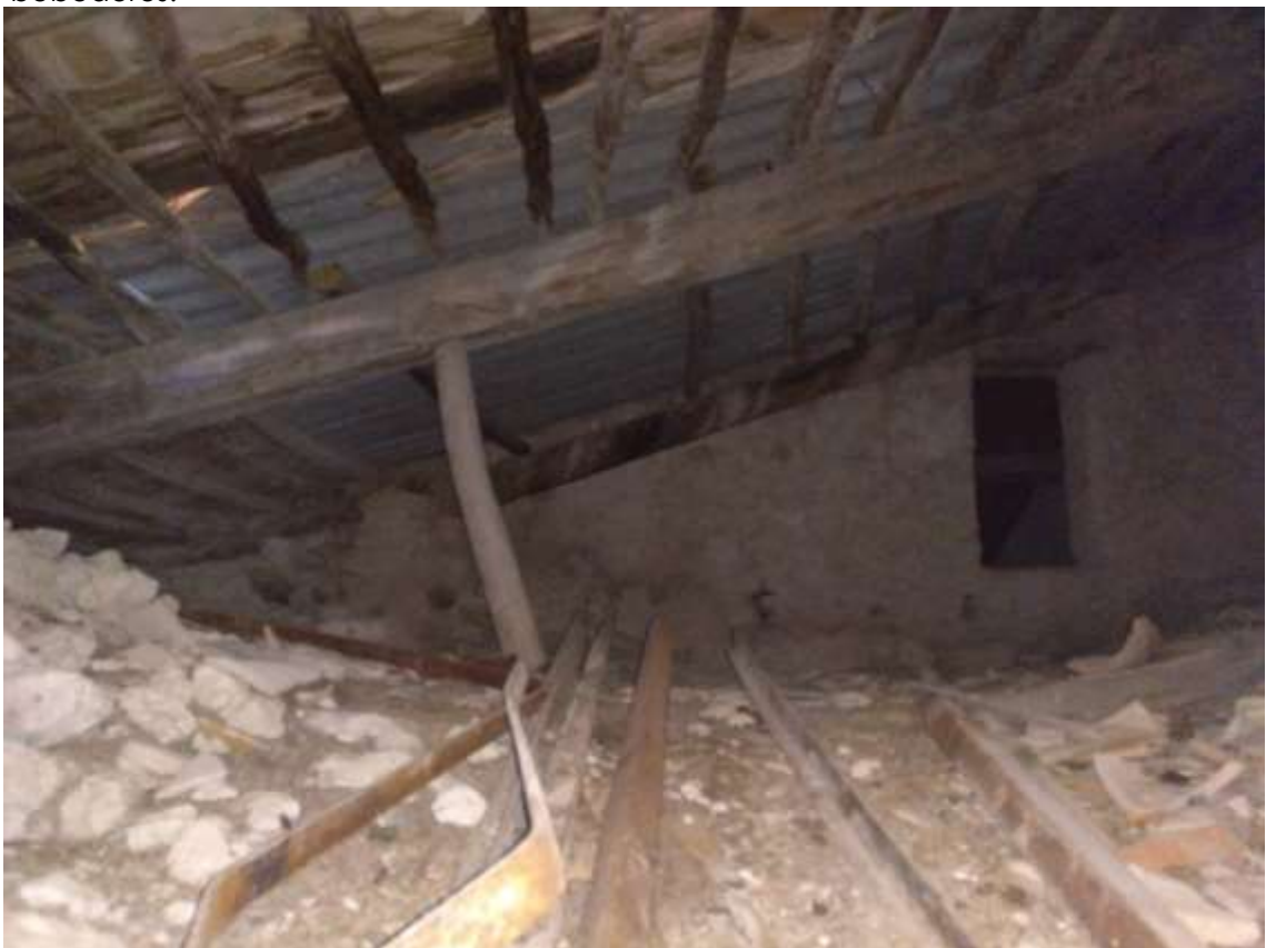
Vista de la cubierta de la construcción que corresponde con los bebederos y el aljibe.
