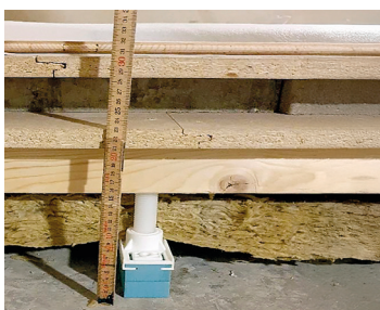
M17/M26. Referensbjälklag betong, Ljudfot 50 mm med 150 mm plastskruv, Forestia golvspånskiva P6, betong 50 mm, Aerolen, parkett. CC400 mellan reglar.
