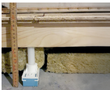
M4/M18. Referensbjälklag betong, Ljudfot 25 mm med 150 mm plastskruv, golvspån 22 mm, Aerolen, parkett.
