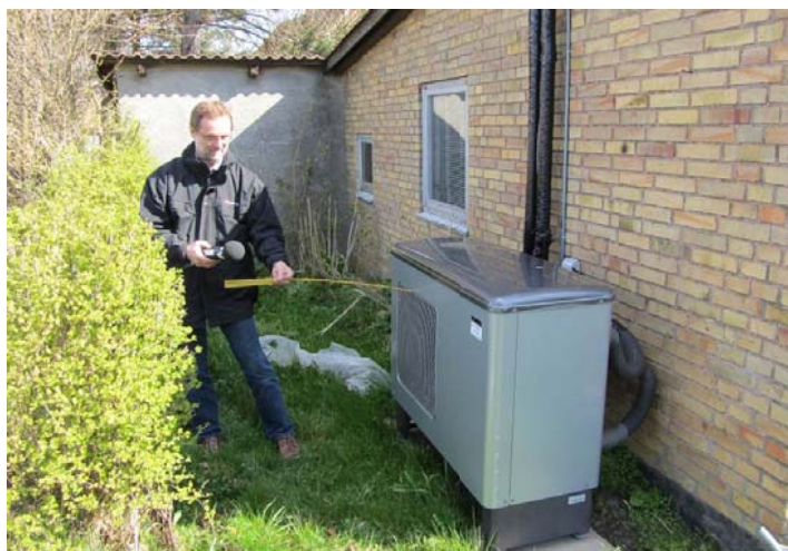
Figur 11.3.1 Kontrolmåling af installation
