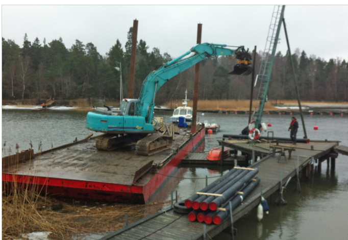
Ny pålning med hjälp av grävskopa. Moderna rör som efter pålning fylls med betong för att motstå sjö och is.
