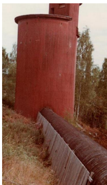
Trykkutjevningstårnet i enden på trerøret fra Beritknappen
