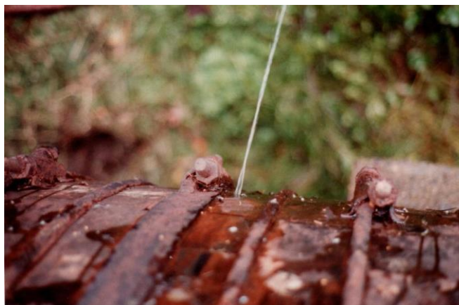
Lekkasjene på trerøret var mange.
