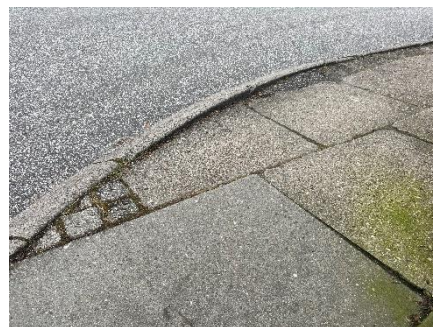
Billede 17: Kant på over 30 mm mellem kantsten og fliser
