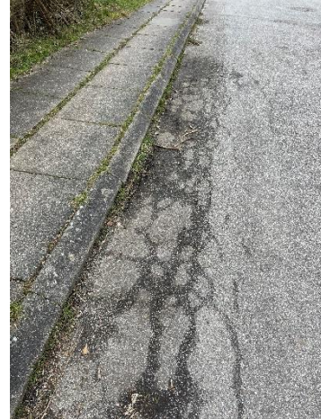
Billede 10: Sætning og krakelering
