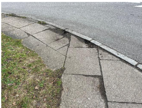
Billede 18: Kant på over 30 mm mellem kantsten og fliser
