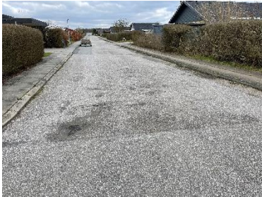
Billede 8: Skader ved tilslutning til "stamvej"
