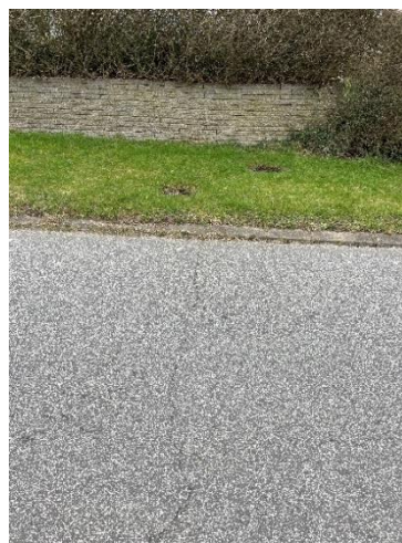
Billede 3: Tværrevner ved spildevandsbrønde
