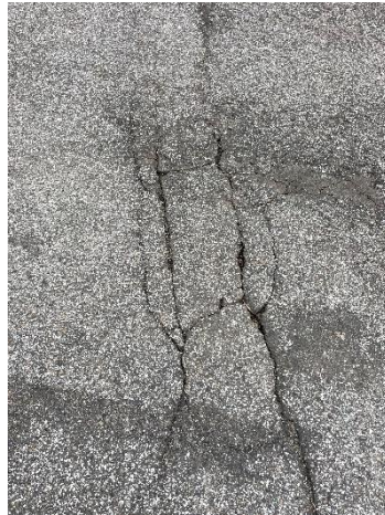
Billede 9: Gennemgående krakeleringer
