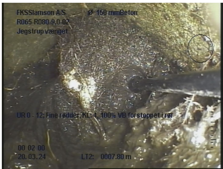
FOTO 015 00:02:00 7,8 m RØ.F4 100% VB forstoppet i rør
