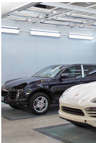
Vorbereitungsplatz mit Gitterberostung, Rahmen und Abluftaggregat
