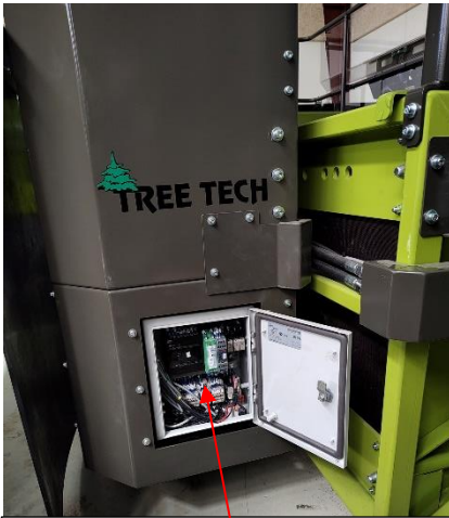
Armoire électrique sous la cage de l'équipage
