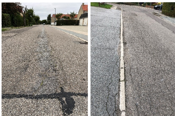
Figur 9 Kraftige rivninger og mørteltab på Vosborgvej.
