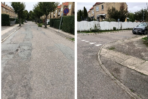
Figur 10 Skader på stikvejene. Lapper, krakeleringer, slaghuller. Samme skader som de resterende veje er observeret.
