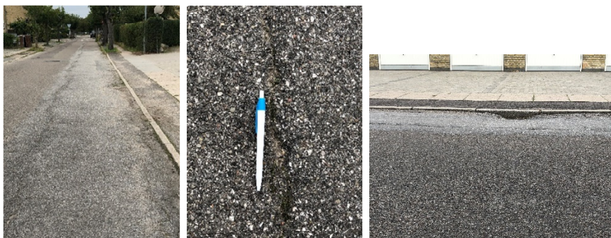
Figur 8 Til venstre: Revner i hele midt kørebane på Vosborgvej. Til midt: Tykkelse af revnen. Til højre: Risten sidder i en lunke.
