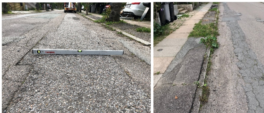
Figur 3 Til venstre: Jævnhed målt med retskede på lapning efter ledningsarbejder. Til højre: Lapningen er en anden type belægning (farveskift fra original til lap), og lapper er krakeleret. Kantstenslysningen er lav.
