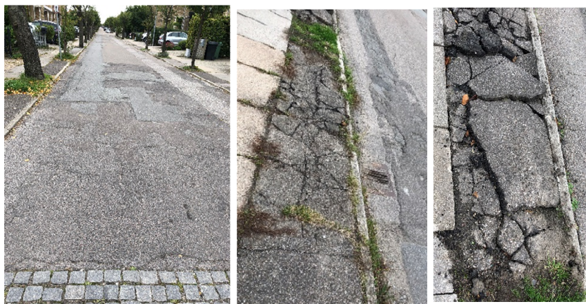
Figur 2 Til venstre: begyndelsen af Jacob Appels Allé i stationering 0. Revner er dannet rundt omkring lapningen. Til højre (begge billeder) skillerabatten er mange steder på strækningerne revnet.
