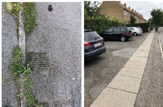
Figur 7 Til venstre: Rist der er lukket til med sand, placering: tættest mod Vosborgvej. Til højre: P-plads med revner og afskalninger.
