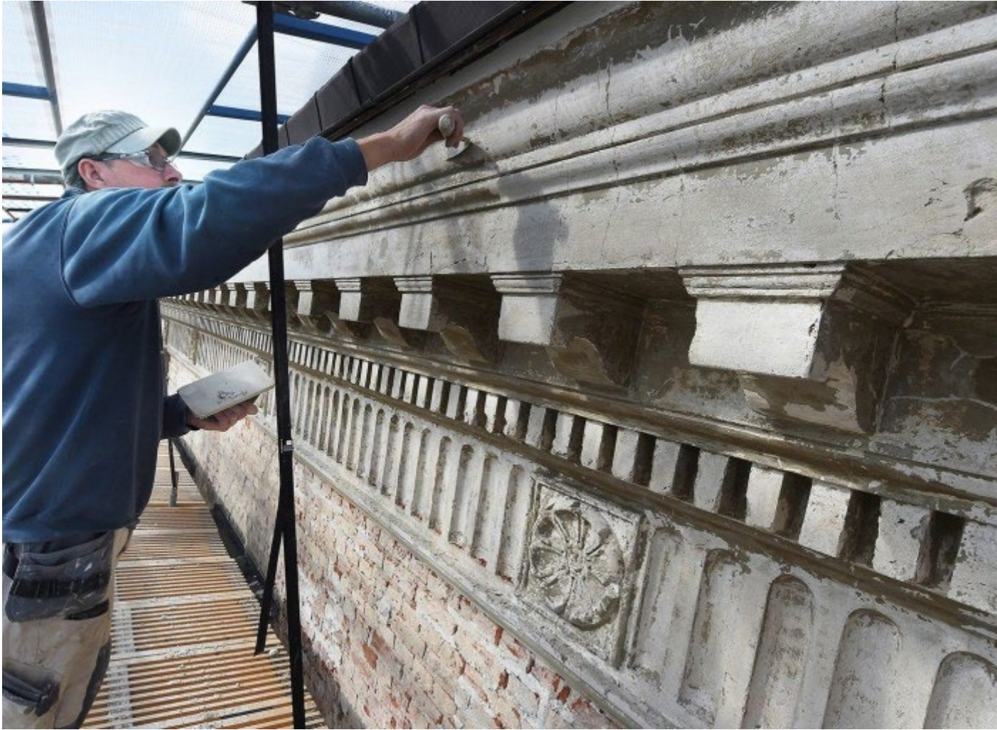
Lasse Persson på Folkes Bygg & Byggnadsvård restaurerar taklisten högst upp på residensets fasad.
