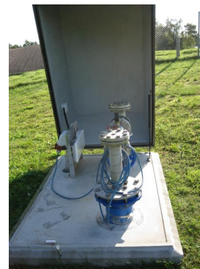
Kilde: Dråby Vandværk. Råvandsstation.
