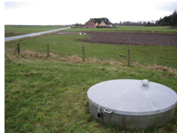
Kilde: Skødshoved Vandværk. Vandboring i tørbrønd.
