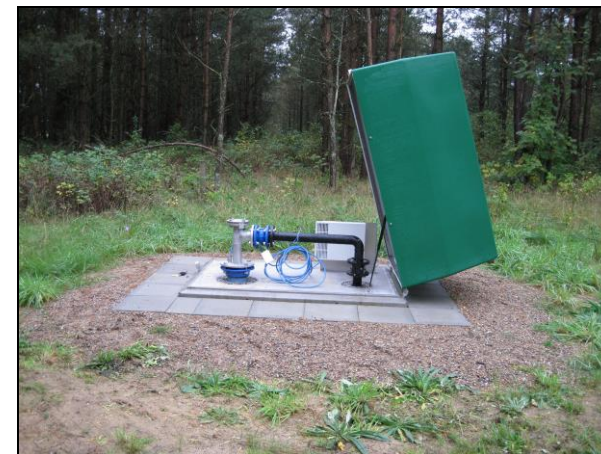
Kilde: Øksenmølle-Fuglslev Vandværk. Kildeplads.
