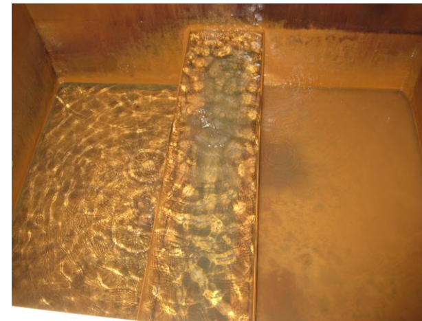
Kilde: Thorsager Vandværk. Åbent sandfilter.
