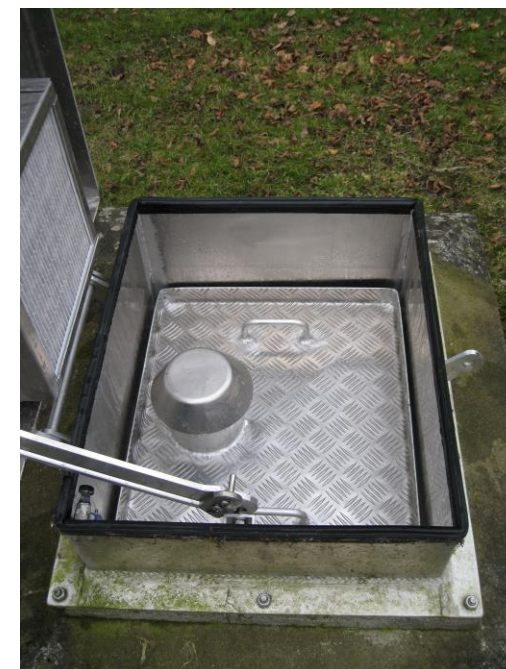
Kilde: Hornslet Vandværk. Nedgang til beholderanlæg.
