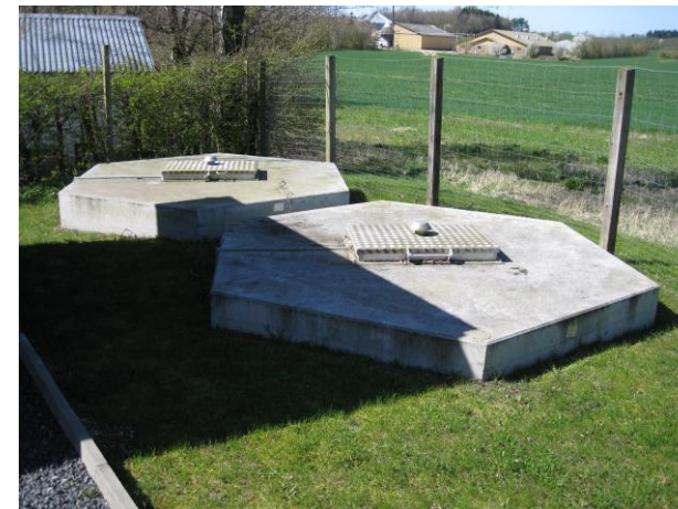
Kilde: Rodskov-Eskeroed Vandværk. Beholderanlæg.
