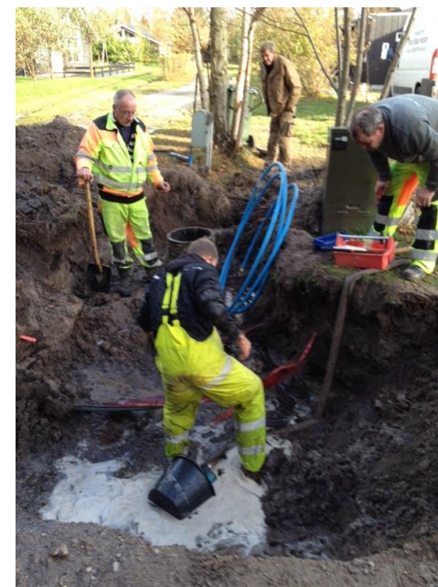
Kilde: Hasnæs Vandværk. Ledningsbrud.
