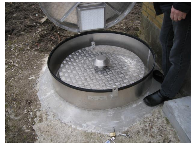
Kilde: Termestrup Vandværk. Nedgang til rentvandsbeholder.
