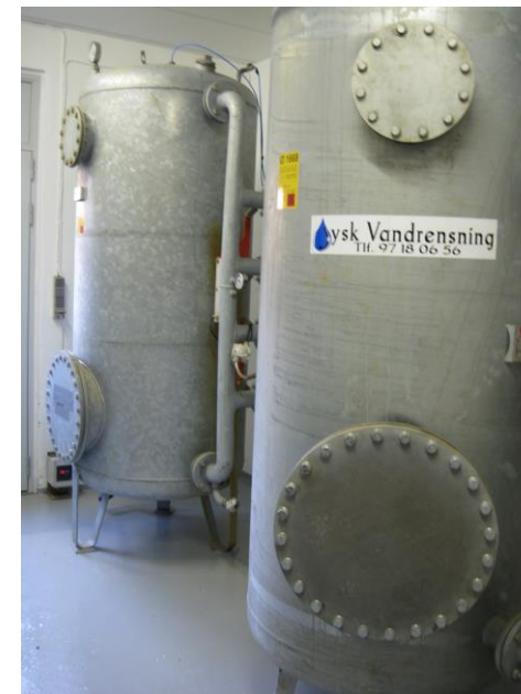
Kilde: Hyllested Vandværk. Trykfilteranlæg.
