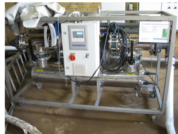
Kilde: Lime Vandværk. Mobilt UV-anlæg.
