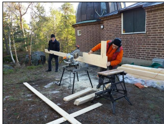
2019-01-05 Henrik Claesson Pipping t.v. och Jacek Bielawski hjälps åt med en del av grundstrukturen. Jaceks kapsåg och arbetsbänk var outhärliga. (GL)
