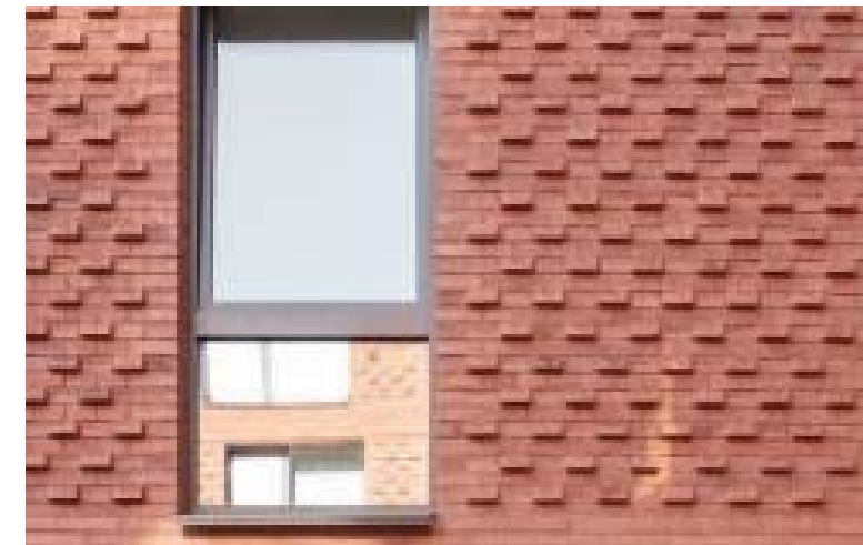
Eksempel på fortanninger i murværket
