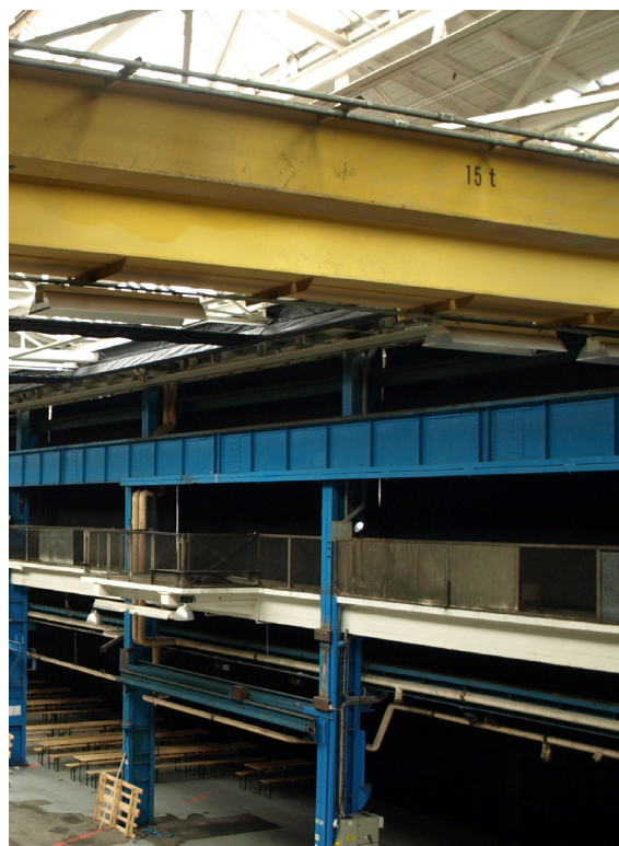
Traværskran i Hal 14
