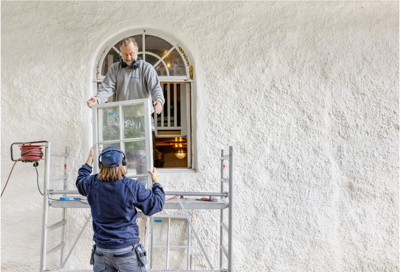
Pågående arbete med att renovera och måla om fönster i Torslanda kyrka, Torslanda-Björlanda församling, Göteborgs stift. FOTO: KRISTIN LIDELL/IKON
