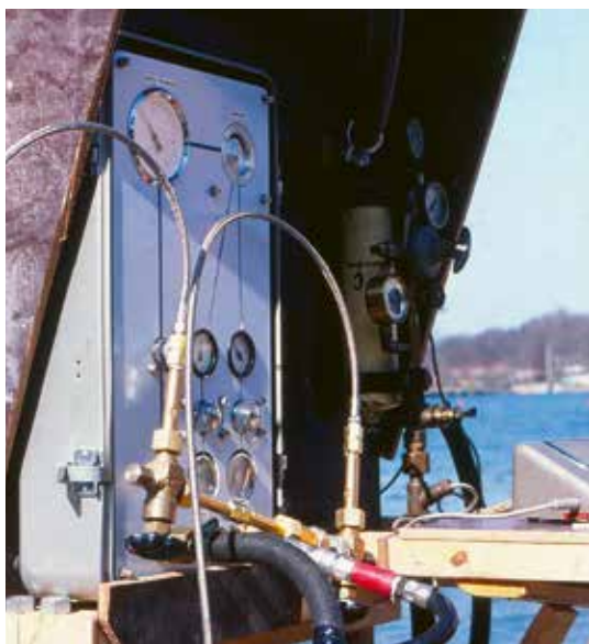
Nitroxblandaren installerad på Dykabs arbetsflotte vid Värtan. Foto: Imre Botos.
