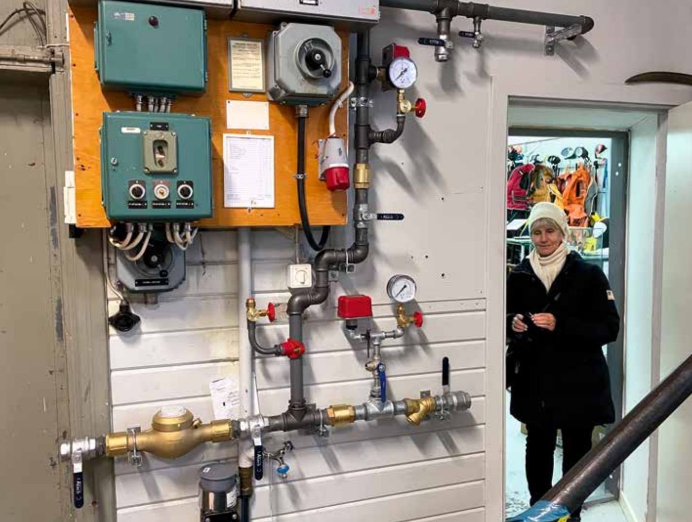
Bisse Örnhagen studerar det nyinstallerade sprinklersystemet. Foto: Hans Örnhagen.
