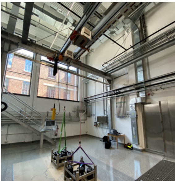
Auf Grund der niedrigen Raumhöhe wurde eine besonders flache und kompakte Lösung entwickelt.
