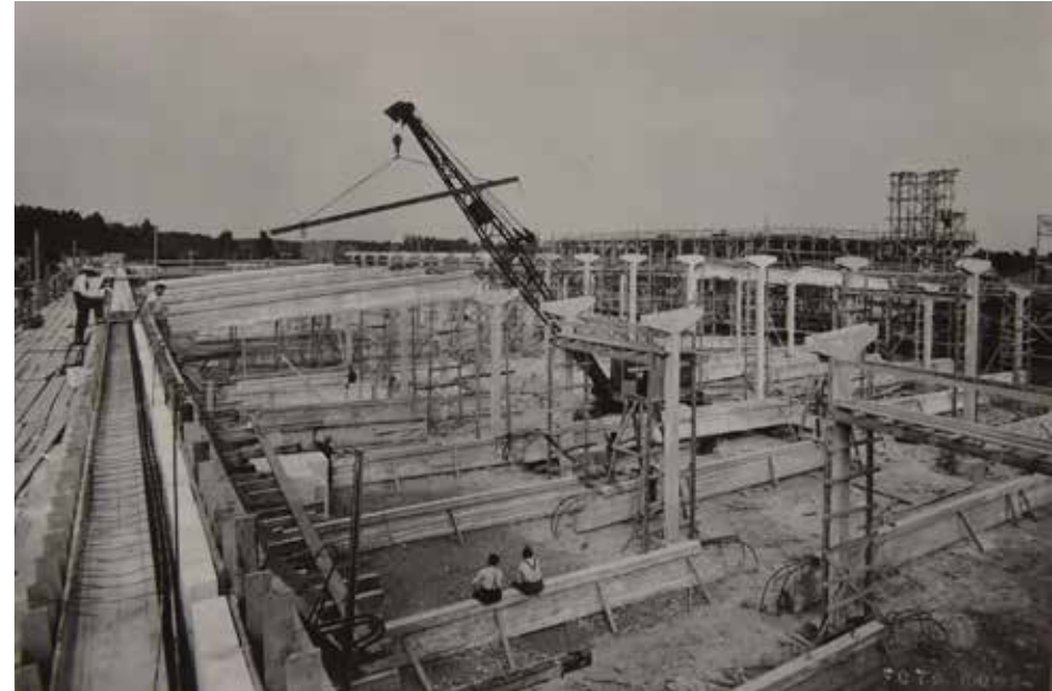
Kuva raitiovaunujen säilytyshallin B rakennusvaiheesta. Helsingin Sanomat ku- vaili työmaata elokuussa 1951: "Koskelan raitiovaunuhallien työmaalta puuttuvat melkein kokonaan betonirakennuksille ominaiset 'telinemetsät'. Hallin keski- osan palkit ja pilarit valetaan näet maassa ja asennetaan paikoilleen nosturin avulla." 265 Kuva Foto Roos 20.8.1951, HKM, reprokuva Sanna Ihatsu.
