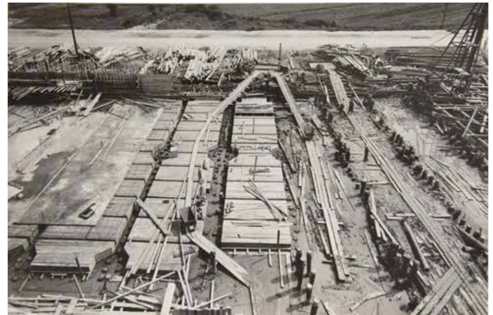
A-hallin perustus- ja pohjarakennustyöt käynnissä. Puupaalutus asennettu ja lattian kaksinkertaisia betonilaattoja asennetaan. Kuva Foto Roos 17.7.1951, HKM, reprokuva Sanna Ihatsu.
