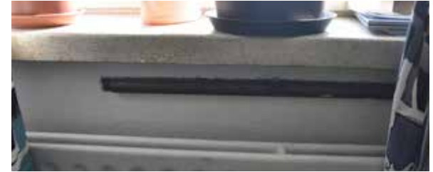
Alkuperäinen korvausilmaventtiili D-rakennuksen toimistotiloissa.
