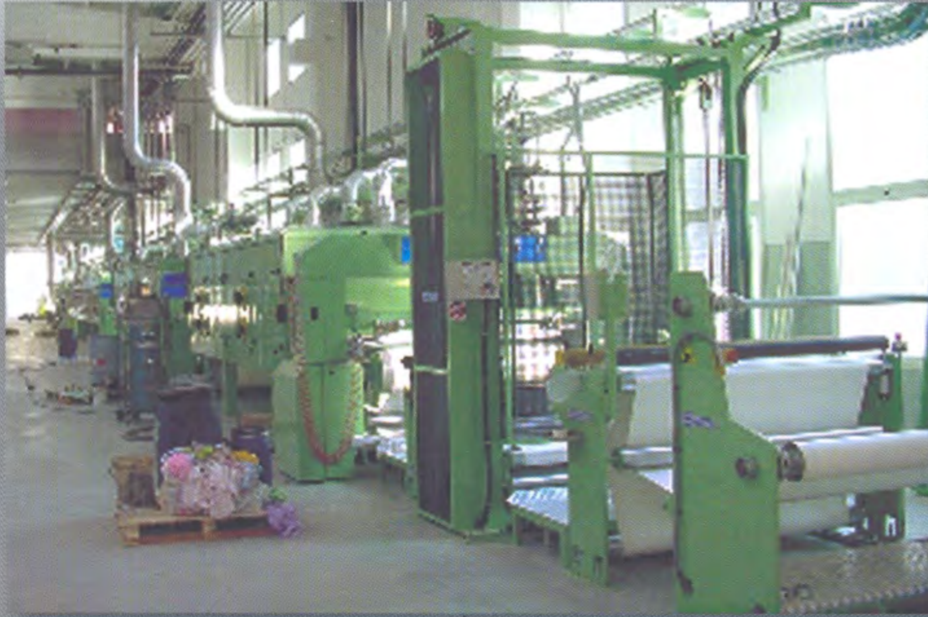
Gruppo entrata linea Inlet group of coating line
