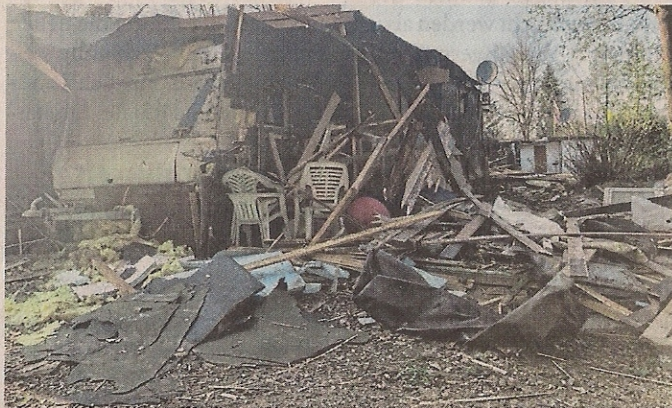
Die Baracke von Andreas V. kurz vor Abriss. Hier hatte das Jugendamt Hameln-Pyrmont ein Pflegekind untergebracht. FOTO: SILKE BUHRMESTER
