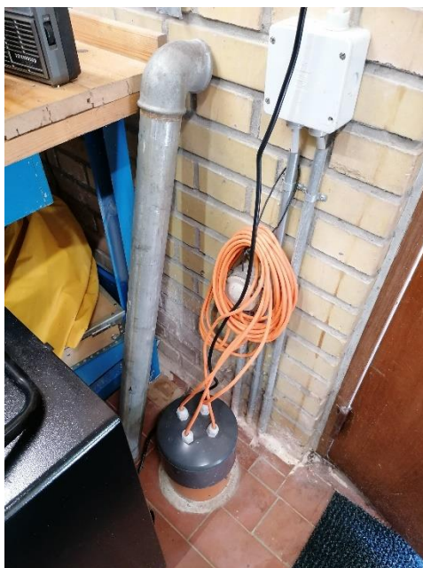
Billede 30 Følere der styrer indvinding
