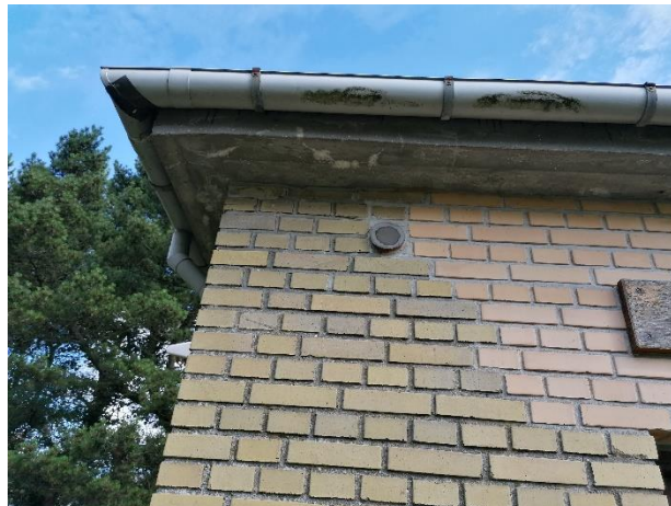
Billede 4 Udluftning – farveskift tyder på rep af mur
