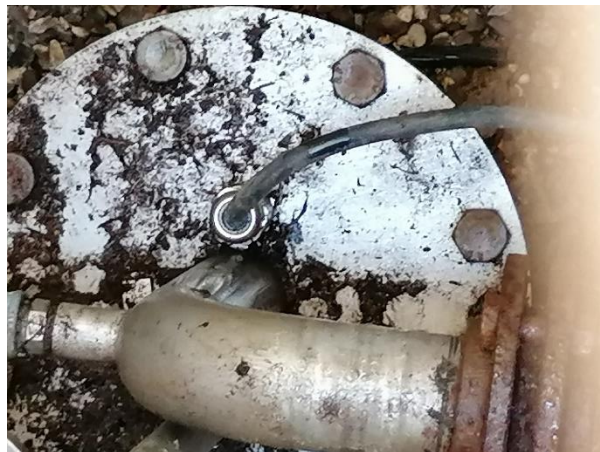
Billede 15 Kabelgennemføring – bemærk skidtet på flangen
