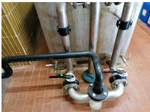
Billede 21 ventilerne til skylning af vand
