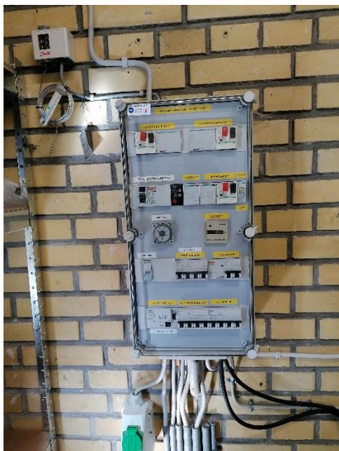
Billede 29 Billede af installation
