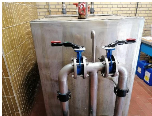
Billede 22 ventilerne for afspærring mod tank
