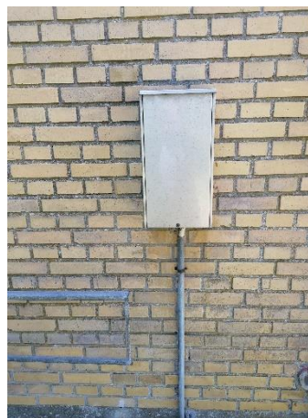
Billede 2 indgang el målertavle fint murværk
