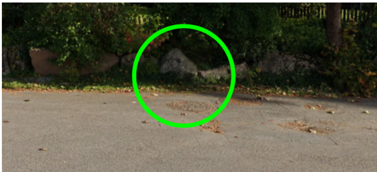
Foto fra veien utenfor Midtoddveien 25 som viser stenen foran venstre kumlukk.
