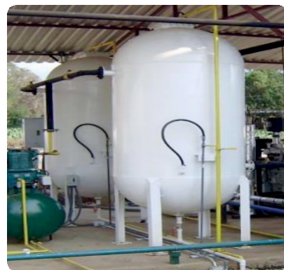
Purificador de biogás
