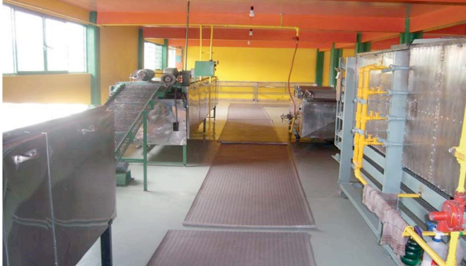
La infraestructura física al interior de la nave industrial, consta de equipo e instalaciones hidráulicas, eléctricas y de biogás al 100%
