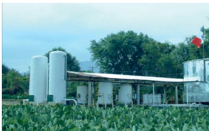
Planta de generación de biogás y electricidad en Zitácuaro, Michoacán. Opera desde el 2010
