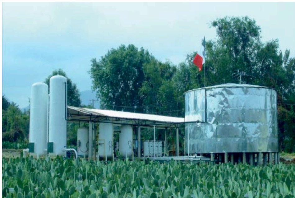
De izquierda a derecha, se aprecian tanques de almacenamiento, tanques de purificación, calentadores y el biodigestor
