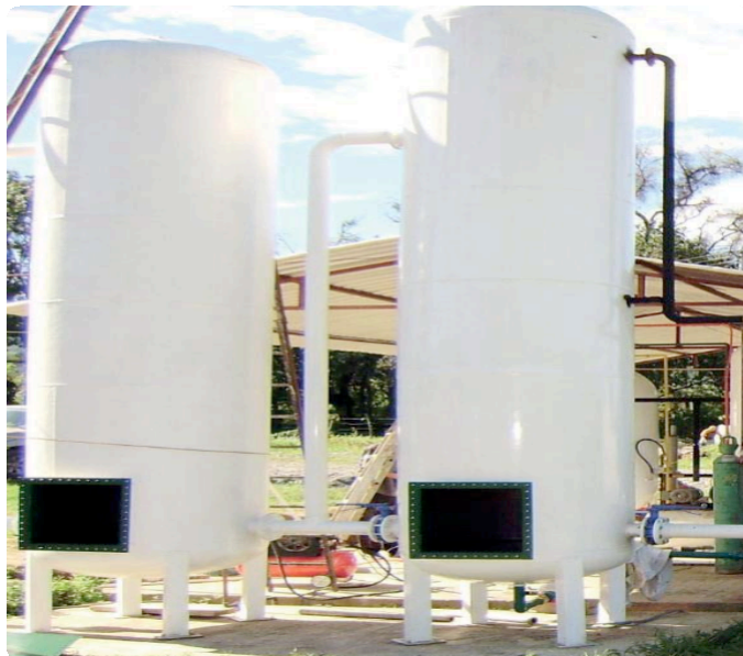
Tanque de aireamiento, izquierda y tanque de recuperación de biogás, lado derecho
