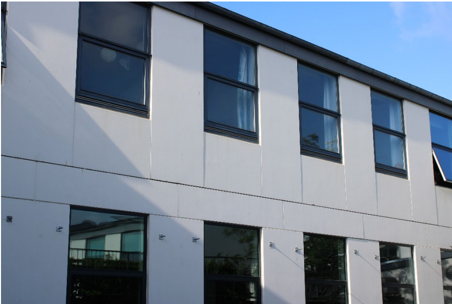
Figur 7. 2 etages bygning. Bemærk udbøjning på midt af facadeelementer i øverste etage.
