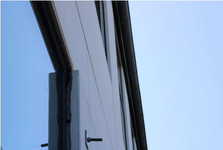
Figur 9. Facadeelement i nederste etage. Bemærk udbøjning af top af nederste facadeelement. 14. juli blev der nedtaget et facadeelement fra en af de 1 etages bygningerne.
