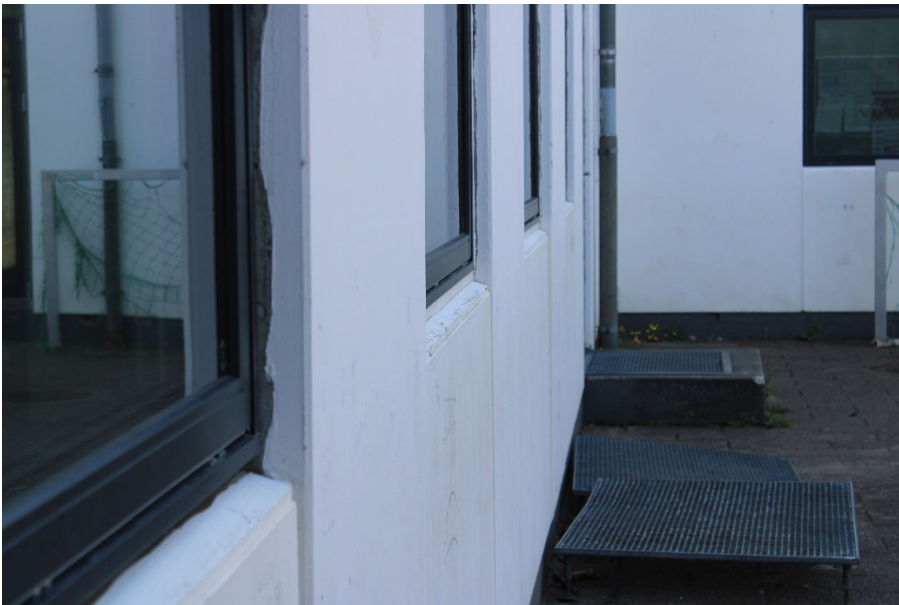
Figur 8. Facadeelementer i nederste etage i bygning med 2 etager. Bemærk udbøjning af facadeelement ved vindue.
