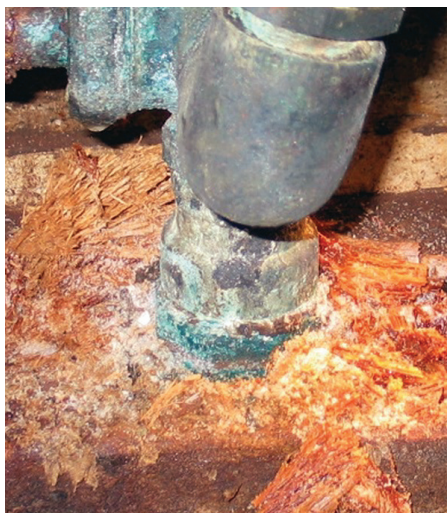
Lut-råte ved ei gjennomføring. Treverket blir misfarget og blir til løse tråder. Vi ser også den karakteristiske saltutskillelsen.
