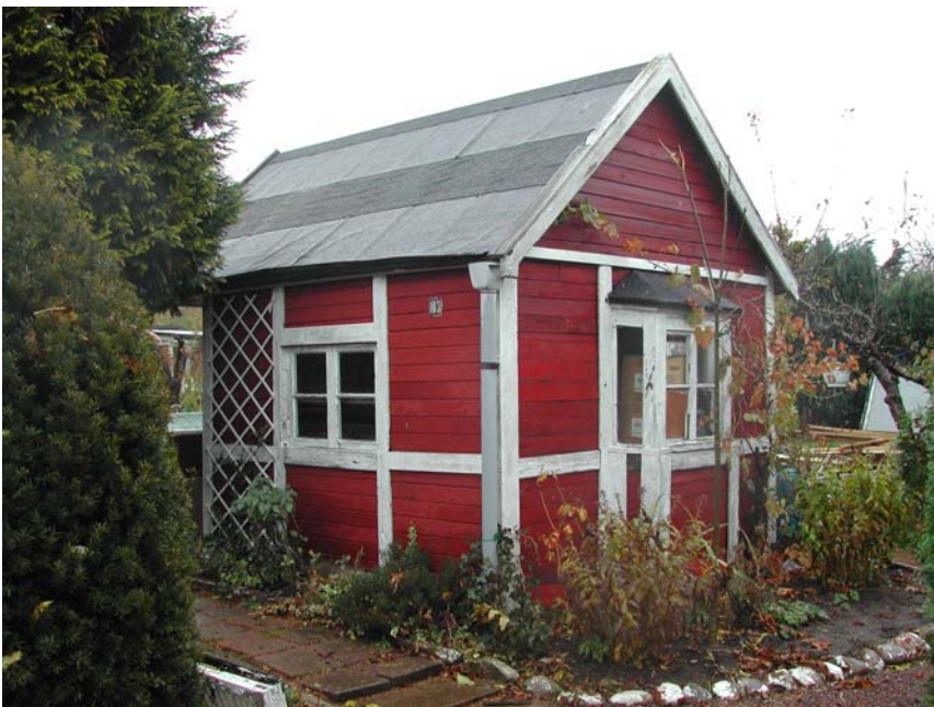
En rivningshotad stuga på tomt nummer 103.
