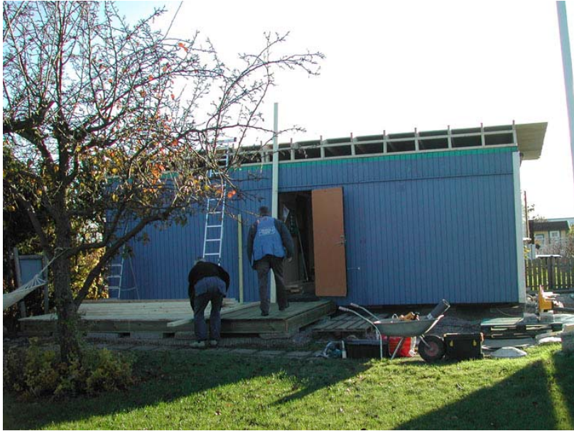
Här byggs en byggbod om till ett aktivitetshus med skapande verksamhet för ungdomar på tomt 68.
