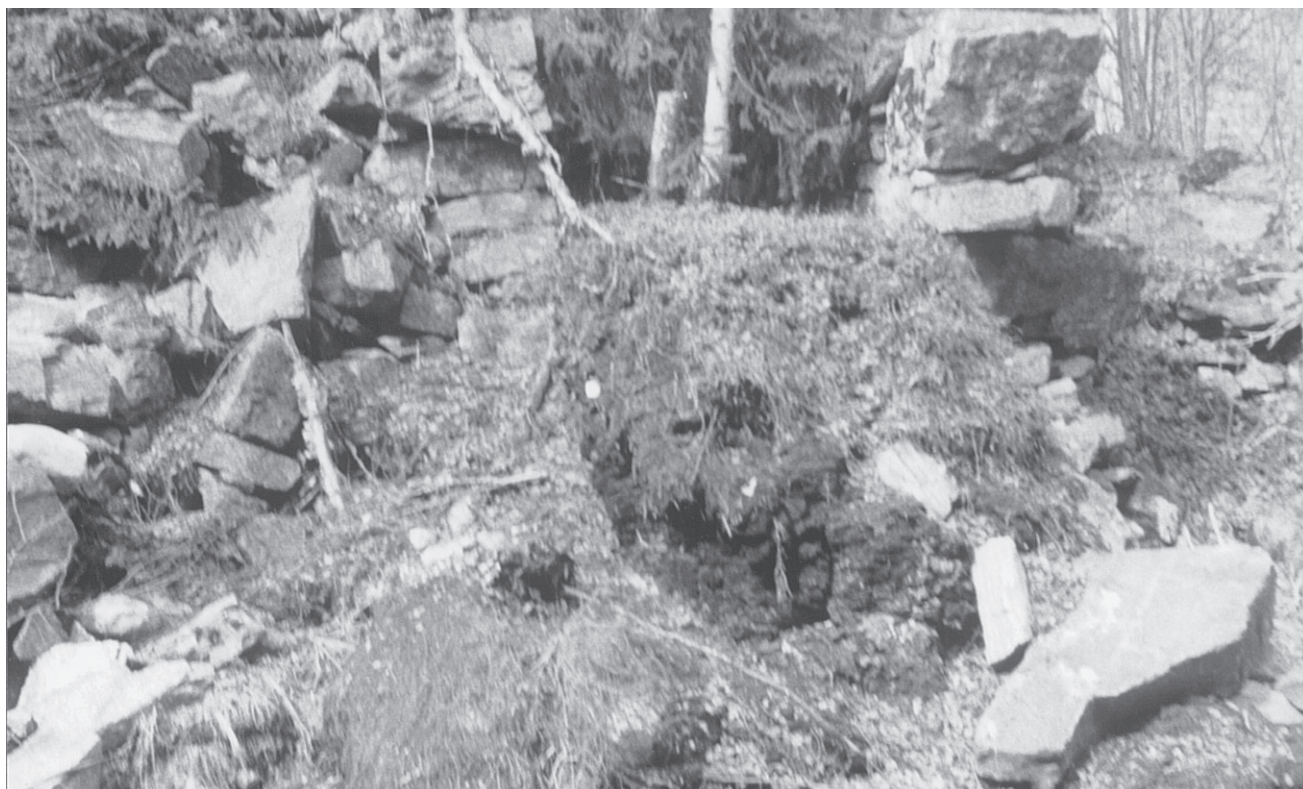
Dammuren ved Nedre Damtjern (Langerud), gjennombrudt av vei i nyere tid. Det var to murer med rosentorv imellom. Torvlaget er lavere, da det har sunket sammen.
