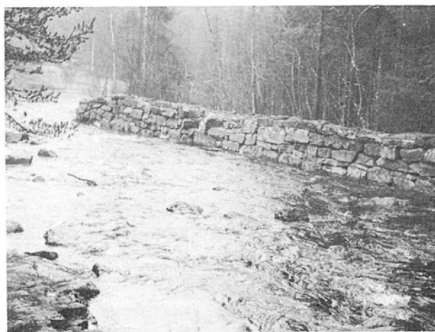
Grunneirne kostet mye på fløtningsforholdene i Henåa. Denne solide muren er syd for Rolia, nord for Gravermoen.
