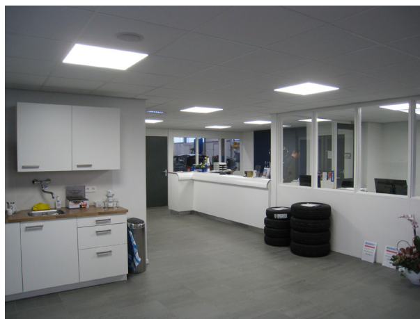
LED panelen in kantoor van een auto dealer
