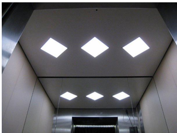
3x LED paneel 295x295 in 4000K gemonteerd in een lift cabine in creatief design
