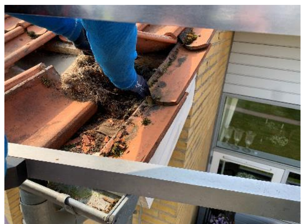
Opfugtet undertag og fugleredder.
