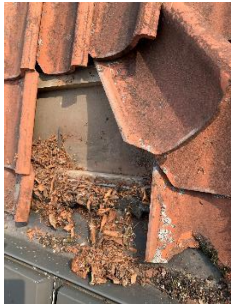
Hultagning 29. Mangler korrekt afvandning samt ophobning af nedfald.
