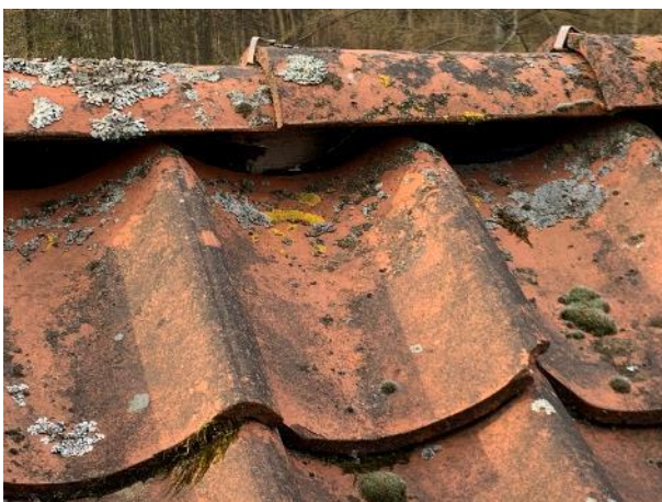
Rykning – ved nr. 3 Ses skade på inddækning
