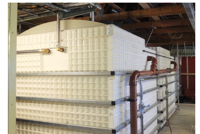
Projekt: Fjällstation Sylarna. Kund: Fjällstation Sylarna Kapacitet: 60 m 3 /dag. Installationsår: 2016
