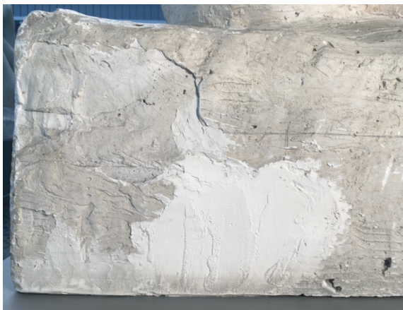
Figur 18: Område på plinten som ble brukt for testing av tørre rensemetoder.
