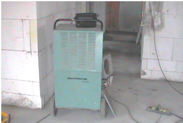
Som kontrol af affugteren, med montering på udvalgte steder
