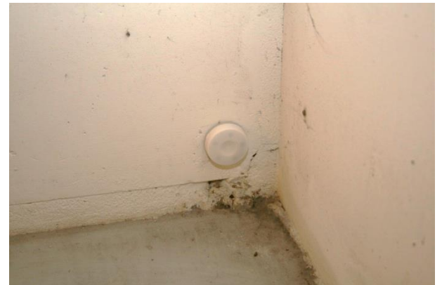
I kælderrum på kolde udvendige vægge
