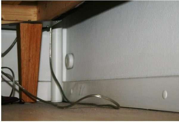
Under sengen på kold udvendig væg
