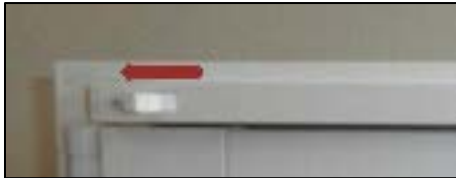
Fällda utåt, ventilen är öppen
