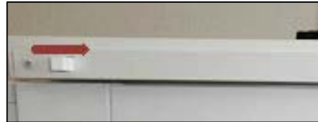
Fällda inåt, ventilen är stängd
