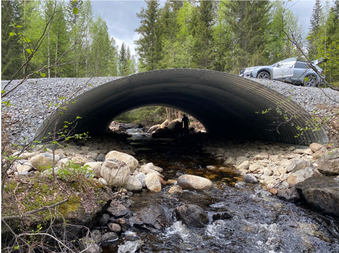
Figur 12. Lågbyggd valvbåge med betongfundament, 9m bred, 16 m lång och 3,5 m hög. Örabäcken, Västernorrlands län.
