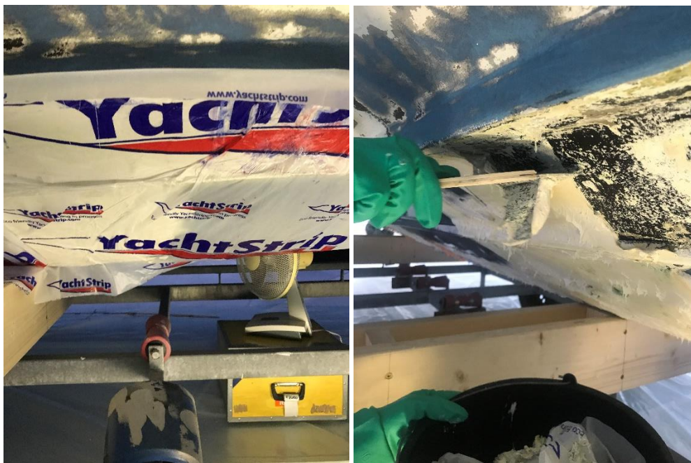
Figur 6. Gelbehandling pågår (till vänster), avskrapning av gel och underliggande färglager (till höger).
