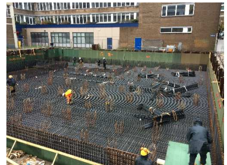
Veel betonijzer aan de onderkant van de poer
