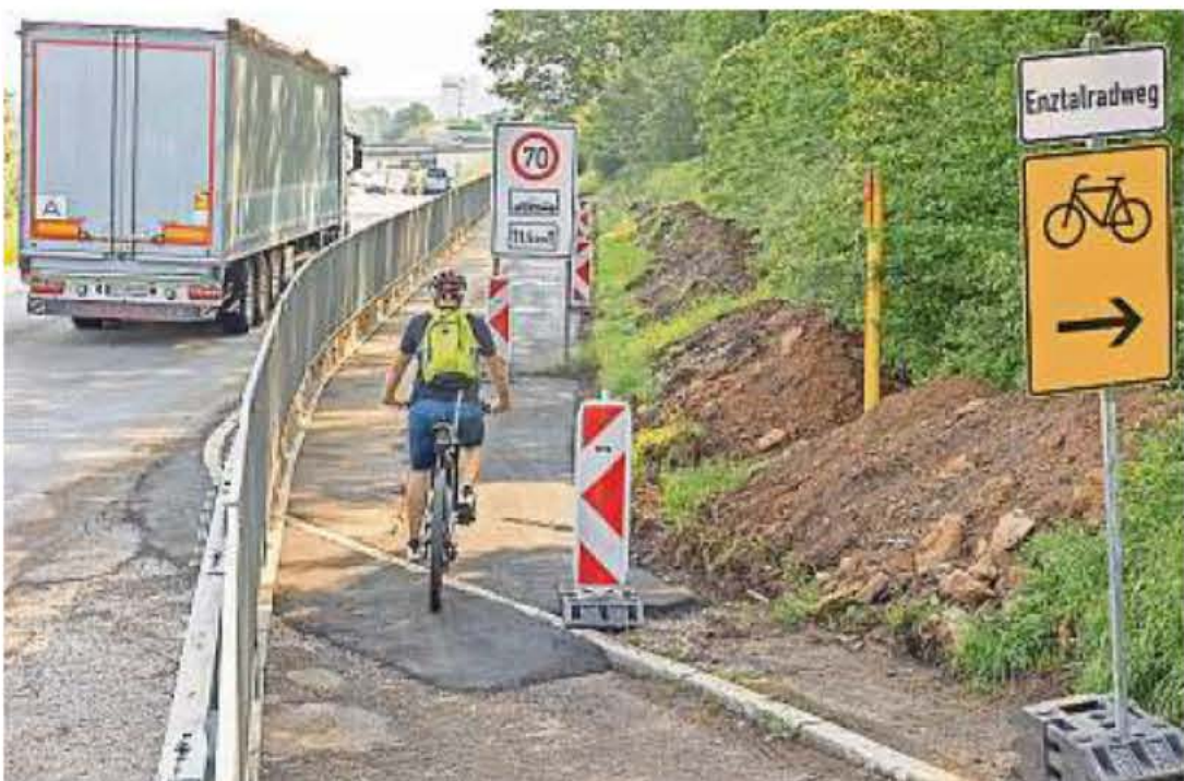
Strittig war die baustellenbedingte Umleitung des Enztalradwegs von Anfang an – hier testet sie PZ-Redakteur Sven Bernhagen im Juni 2021.
