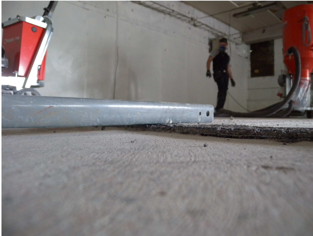
Bild 5. Bilden visar nivåskillnaden mellan golvet betongyta och överytan för flytspacklet i byggnadens norra del. 2011-06-13.
