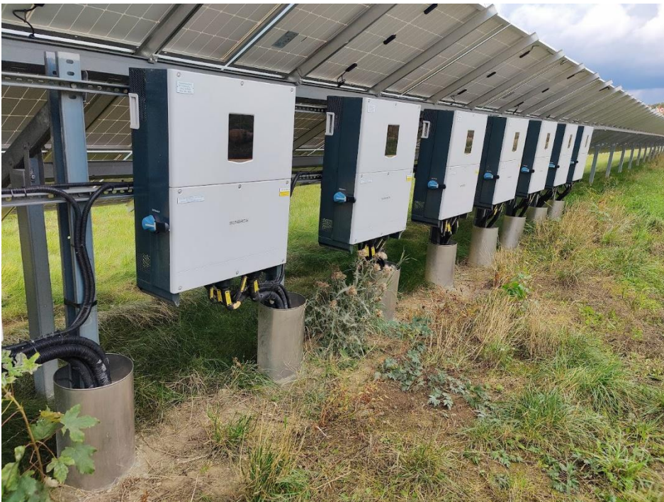
Figur 11. Exempelbild som visar växelriktare på stativ. Bildkälla: Sweco.
