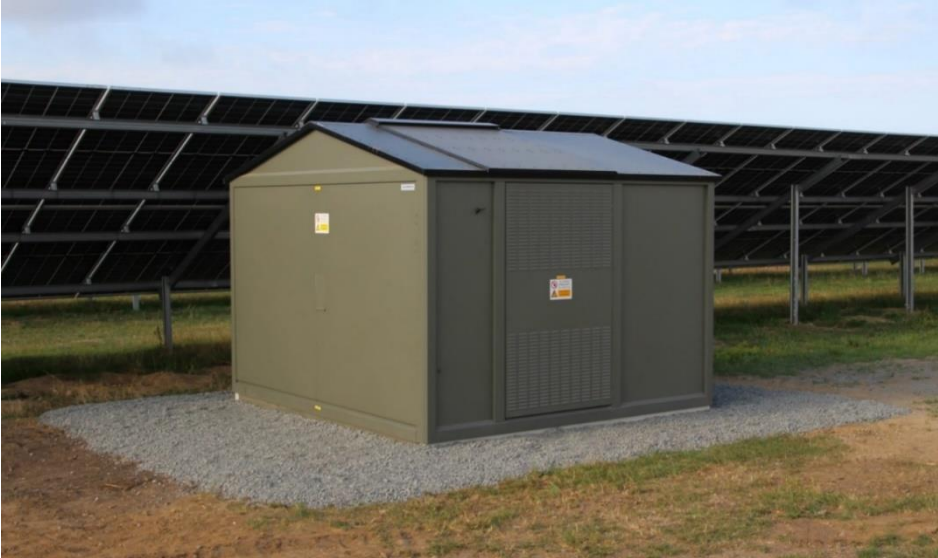
Figur 12. Exempelbild som visar en transformatorstation. Bildkälla: Landinfra.
