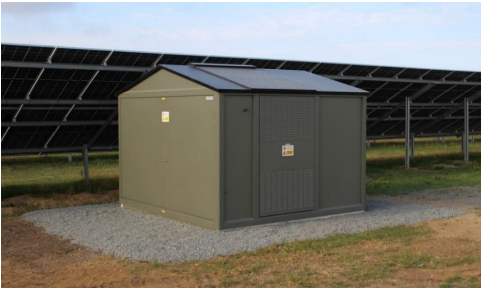
Figur 16. Exempelbild som visar en transformatorstation. Bildkälla: Landinfra.
