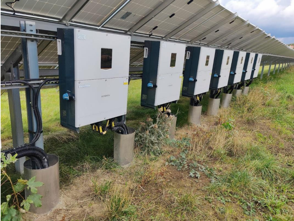
Figur 15. Exempelbild som visar växelriktare på stativ. Bildkälla: Sweco.
