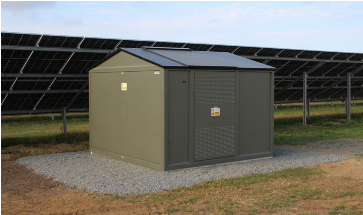
Figur 14. Exempel på transformatorstation. (Foto: Martin Windh, Landinfra)
